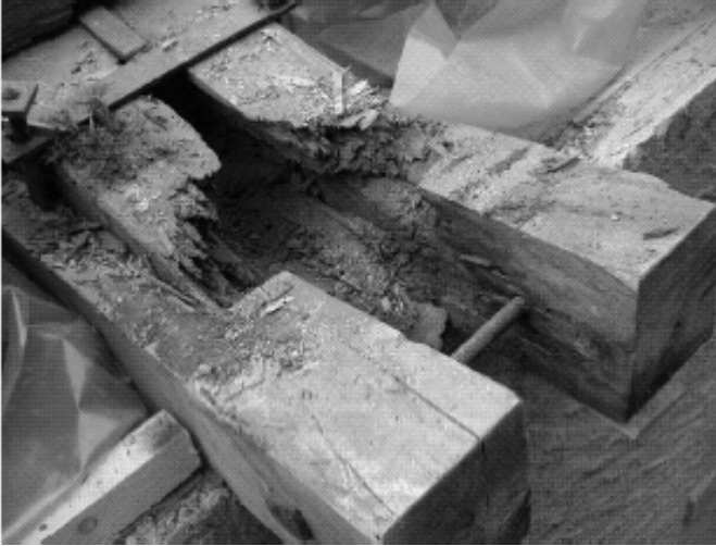
Etat du bois aux points d'assemblage
