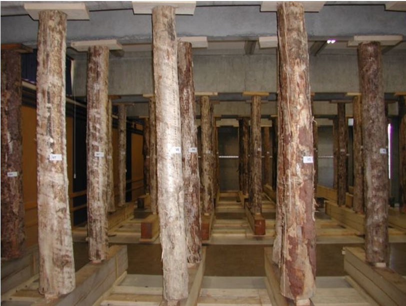
Etayage destiné à renforcer, en tant que mesure d'urgence, les éléments de soutènement principaux
