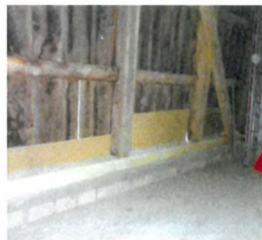
Scheune Vers.-Nr. 001 neuer Fussbalken
