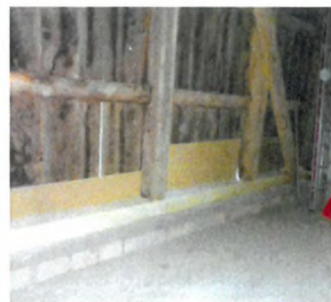
Scheune Vers.-Nr. 001 neuer Fussbalken
